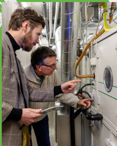
Archiefinspecteur Kevin (op de voorgrond) bekijkt samen met collega Nico de klimaatinstallatie van de archiefdepots van het RAR.
